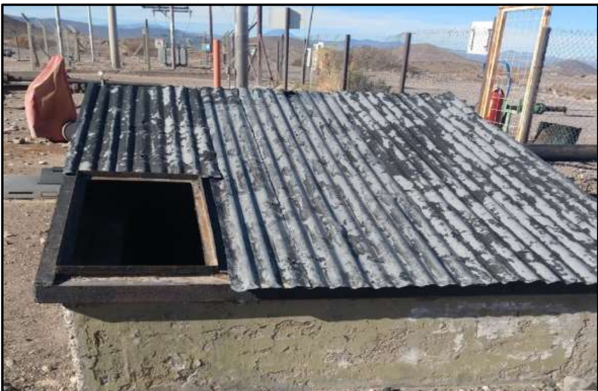
PILETA API DE INSTALACIÓN DE PRODUCCIÓN
