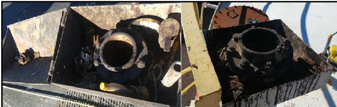
BOCA DE MEDICIÓN DE TANQUE
