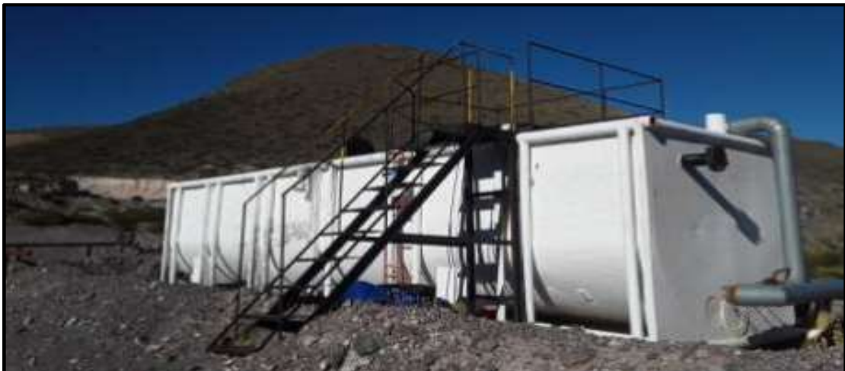
PILETA DE CONTROL DE POZO EN CAMPO
